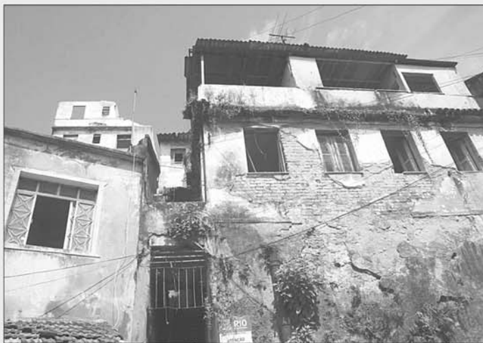
Outra construção condenada: moradores desalojados acabam indo para locais precários
